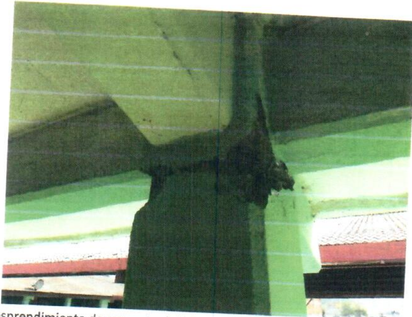
Desprendimiento de concreto debido a su calidad y procesos constructivos
