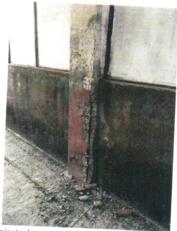
Desprendimiento de concreto debido a la humedad e intemperización
